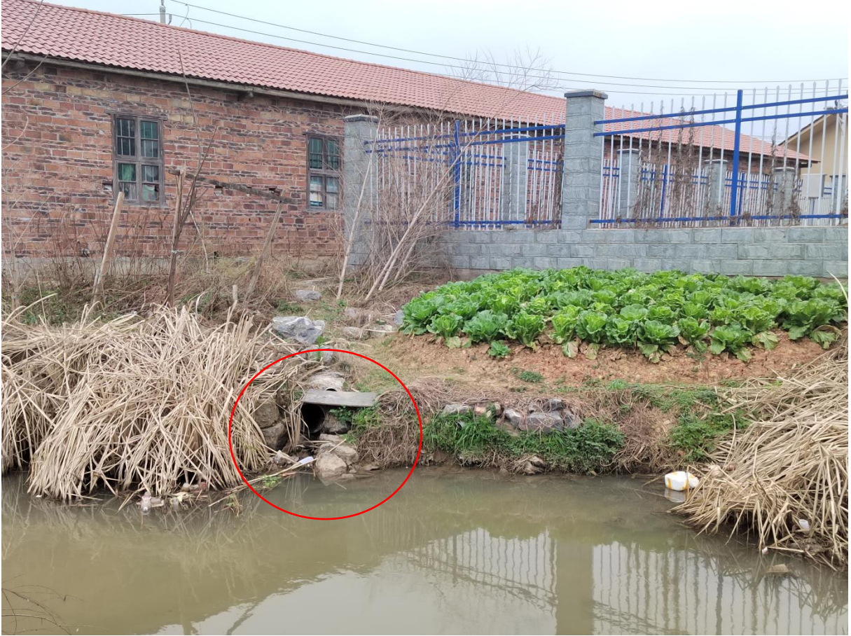
图 5.4-1 “祁东县灵官镇污水处理工程”总排口现状
